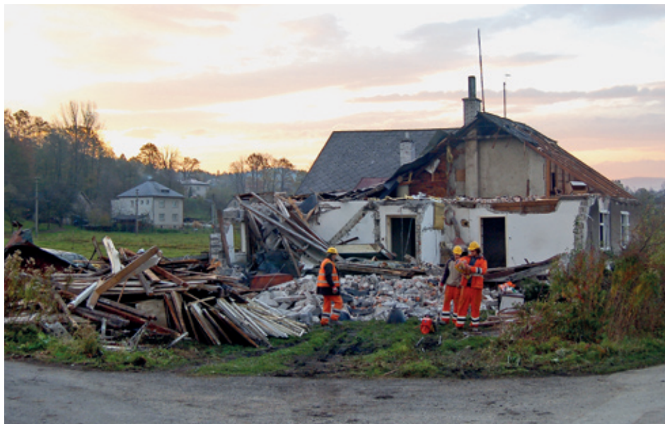
Bourání domu čp. 103 (Heczko guniorz) z důvodu posunutí železnice — Rozbiórka domu nr 103 (Heczko Guniorz) z powodu przesunięcia kolei żelaznej
